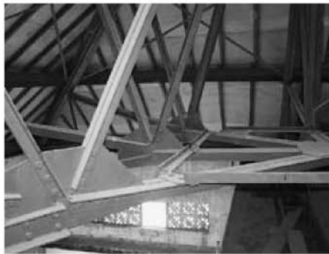
Gambar 3. Gedung Lingkaran Seni di Jakarta. Konstruksi atap baja (foto Arya Abieta, diambil tahun 2004)
